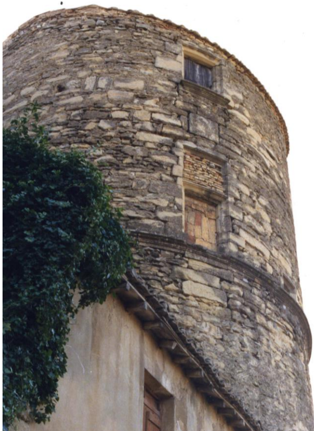
Détails : Tour et blason corrodé ou mutilé. (Photos JLM)
